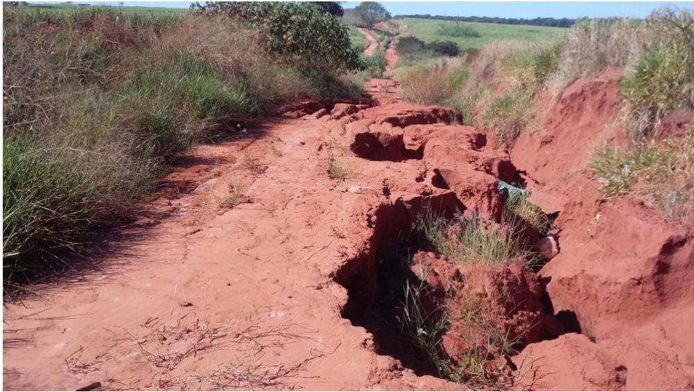
FIGURA 29: Erosão de leito.
