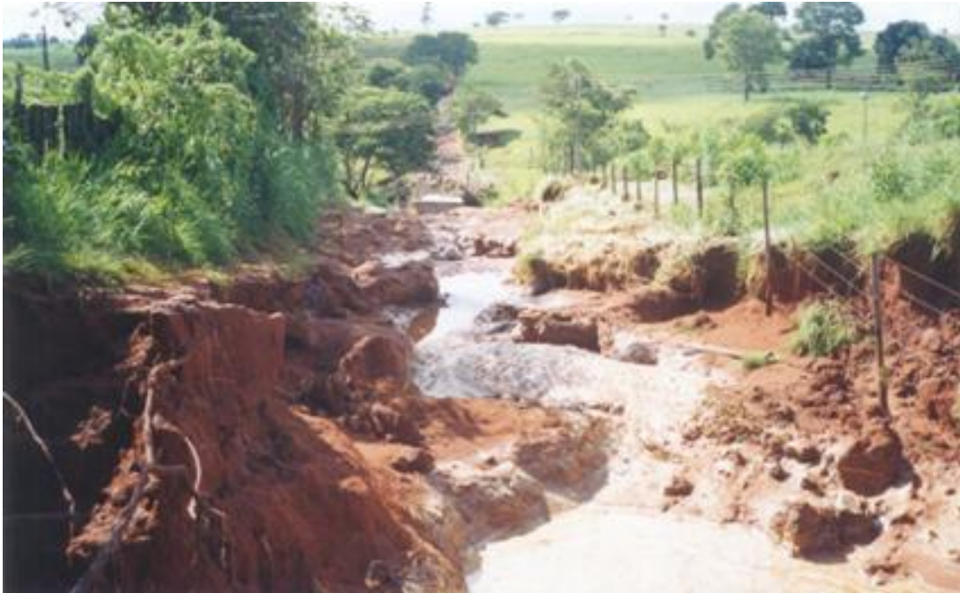
FIGURA 3: Erosão no leito da estrada.
