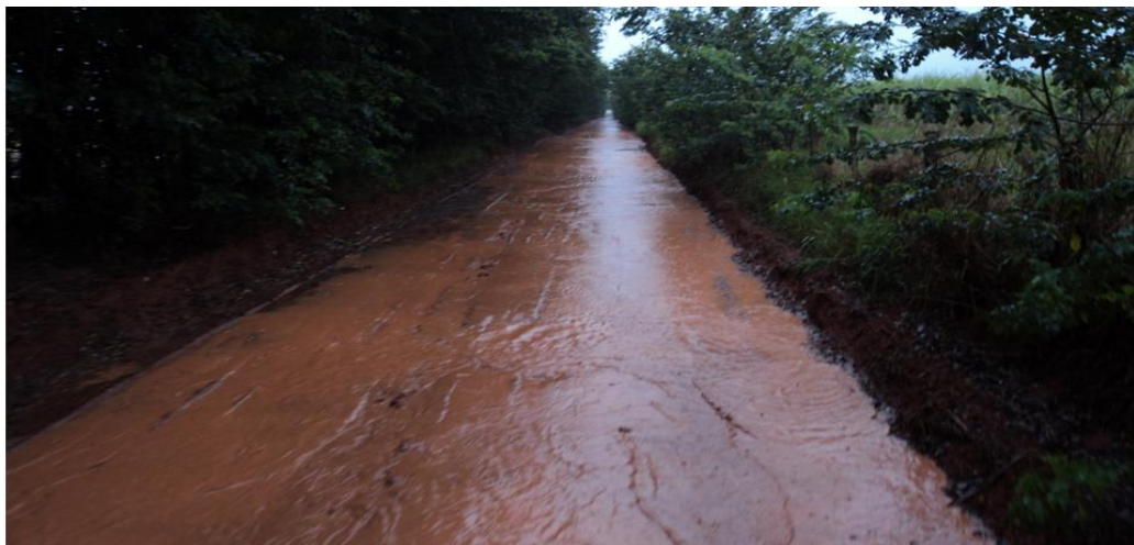
FIGURA 2: Ausência de estruturas de condução e armazenamento de água.
