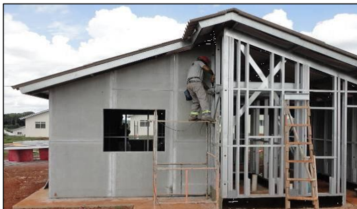
FIGURA 02 : A figura a seguir segue um modelo de construção de uma casa no sistema steel frame .
