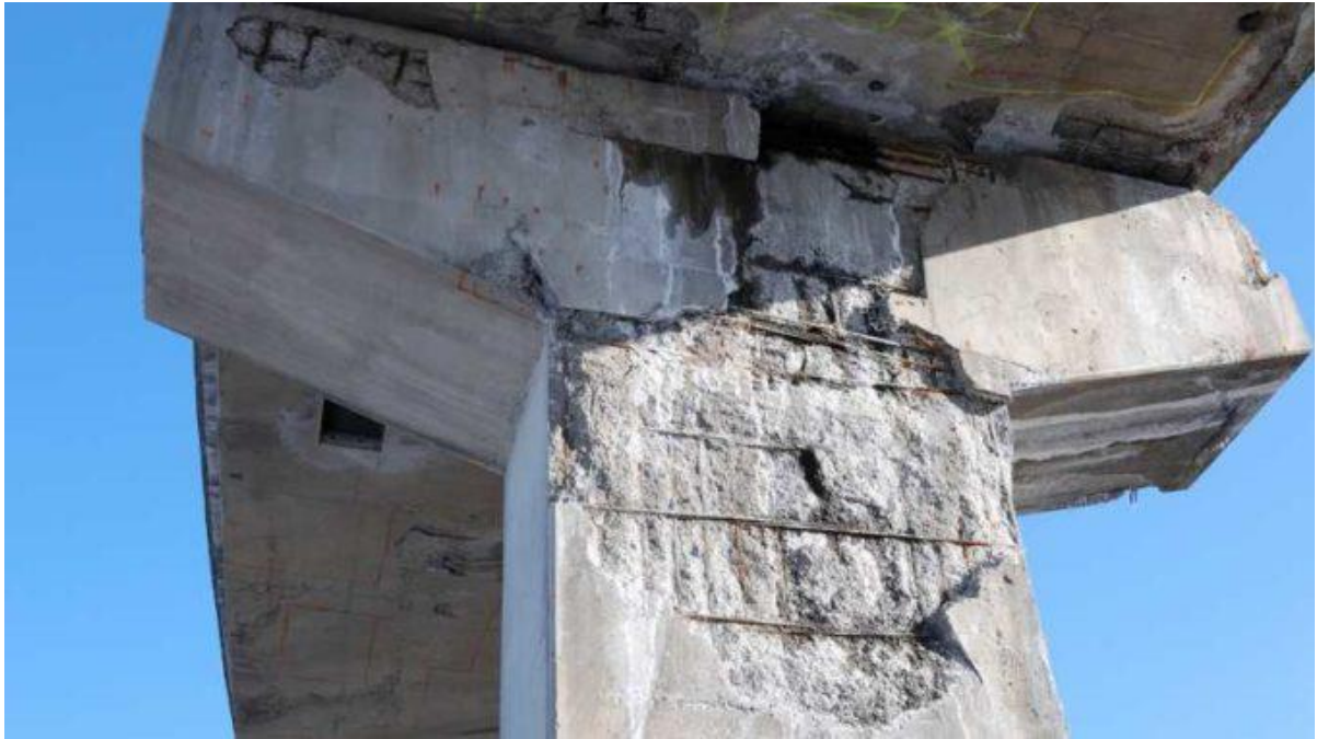
FIGURA 5 – Ponte de concreto armado com armadura exposta após desprendimento do concreto.
