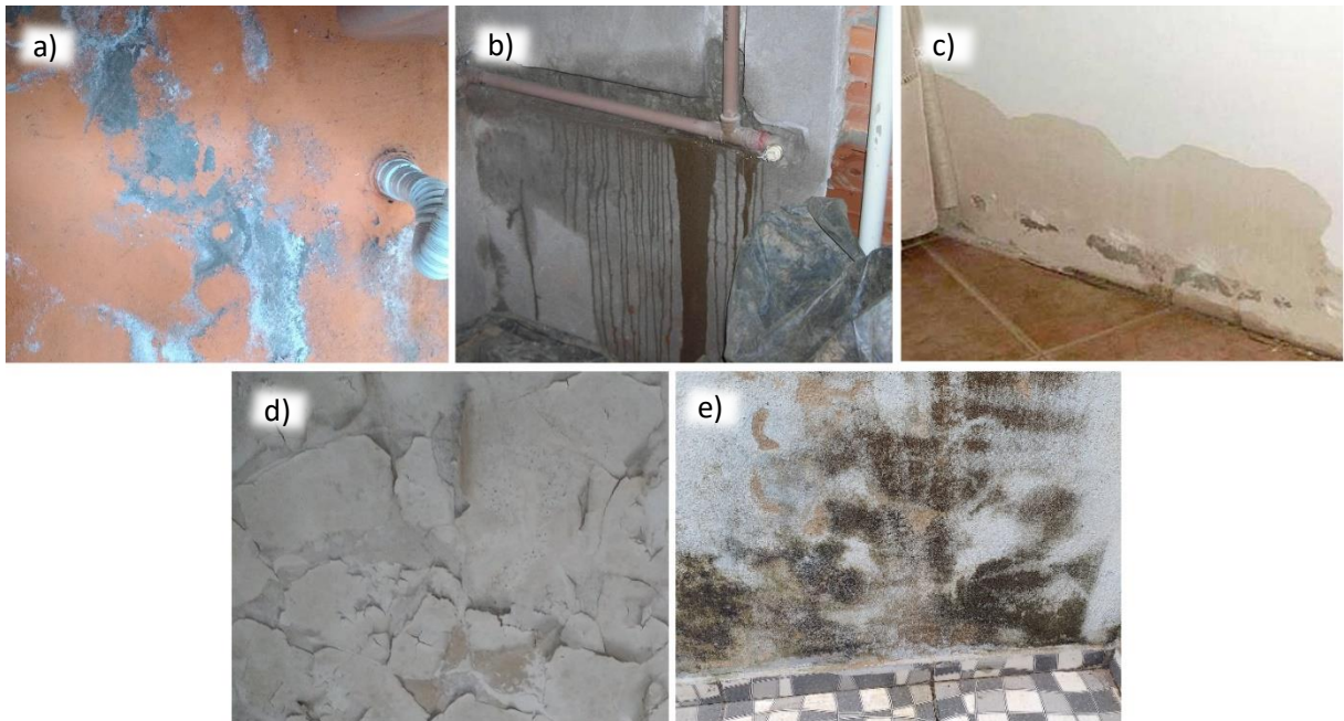
FIGURA 3 – a) Eflorescência; b) Vazamento de tubulação de água fria; c) Infiltração por capilaridade; d) Destacamento da pintura; e) Bolor devido a águas pluviais.
