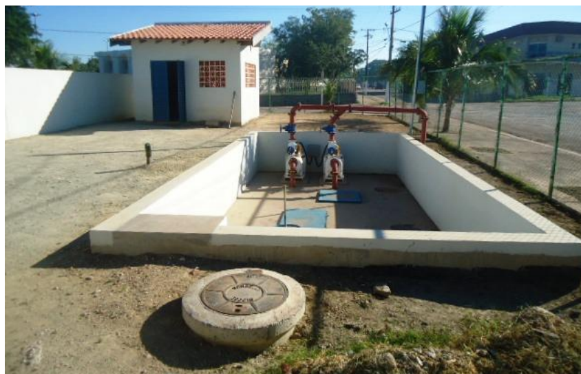
Figura 34 – Estação elevatória de esgoto
