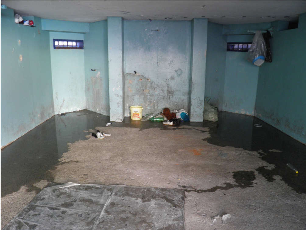
FIGURA 3 – Umidade na Área de Uso Comum. Centro de Detenção Provisória de Praia Grande.
