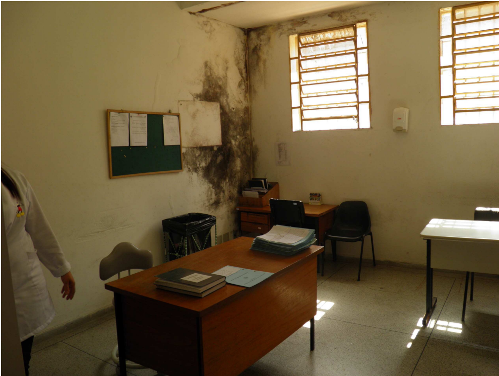
FIGURA 4 – Enfermaria em Péssimas Condições de Trabalho
