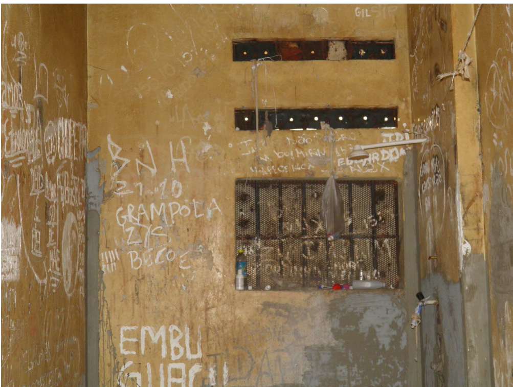
FIGURA 5 – Cella do “Castigo”. Entrada de Ventilação e Iluminação Obstruídas. Centro de Detenção Provisória de Itapequerica da Serra.
