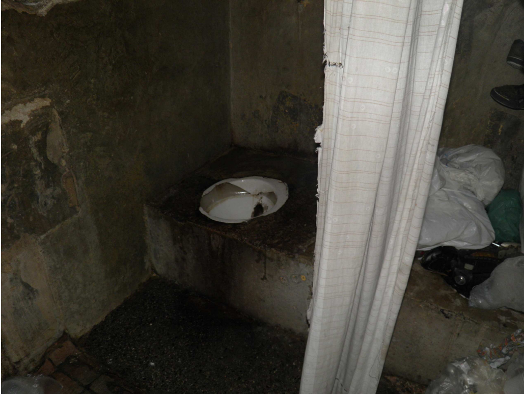
FIGURA 2 – Instalação Sanitária em Péssimas Condições. Chácara Belém I
