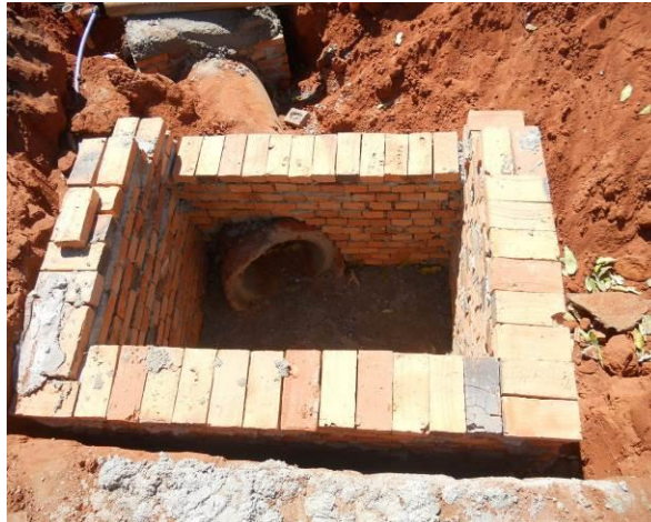
FIGURA 11 – Boca de lobo com tubos de conexão
