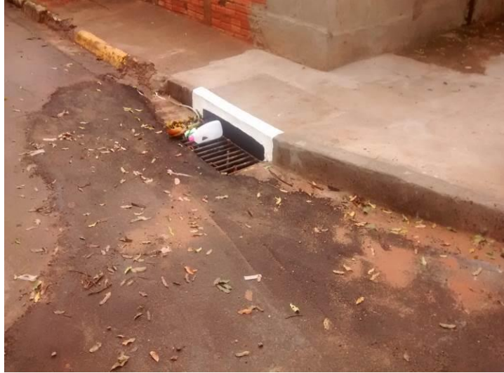
FIGURA 9 – Boca de lobo combinada
