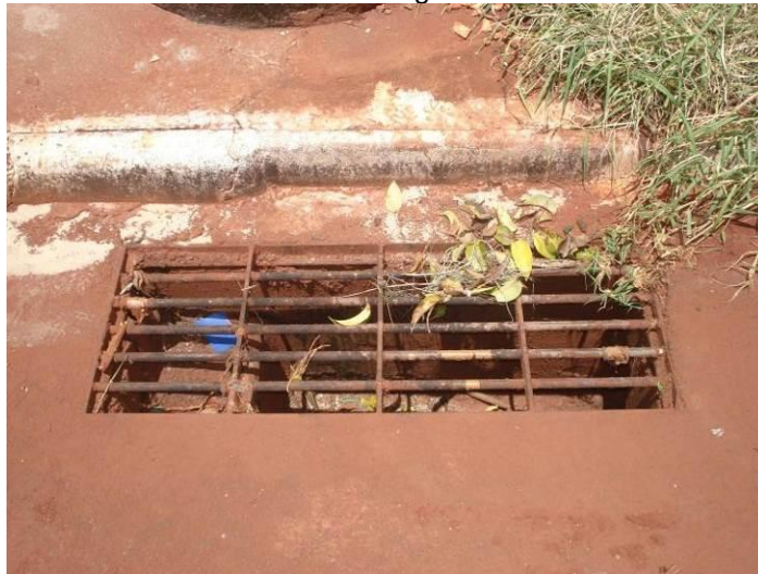
FIGURA 8 – Boca de lobo com grelhas
