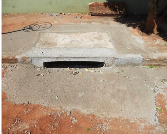
FIGURA 7 – Boca de lobo simples
