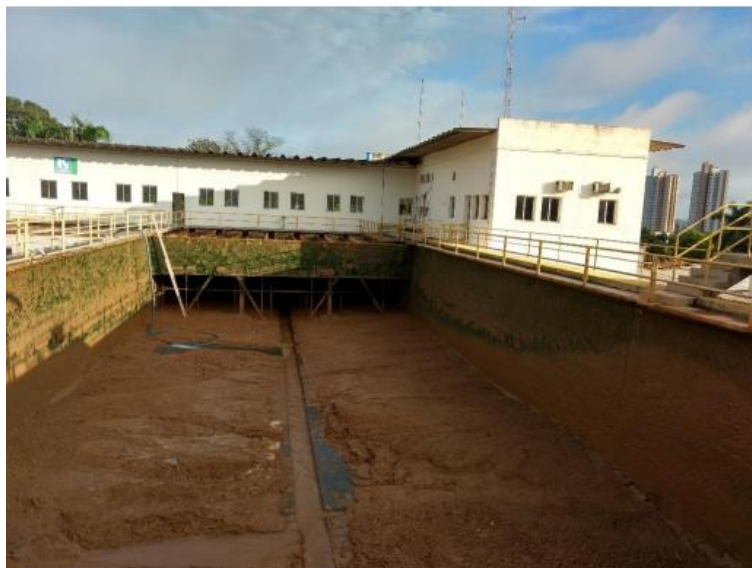
FIGURA 2 – Lodo formado após o processo de decantação da ETA
