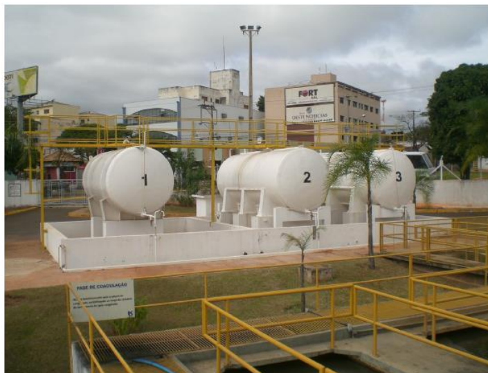
FIGURA 2 - Vista dos tanques de armazenamento do cloreto de polialumínio.
