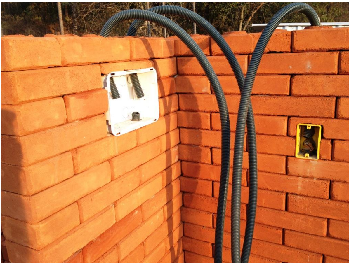
Figura 02: Infraestrutura elétrica instalada em blocos de solo-cimento
