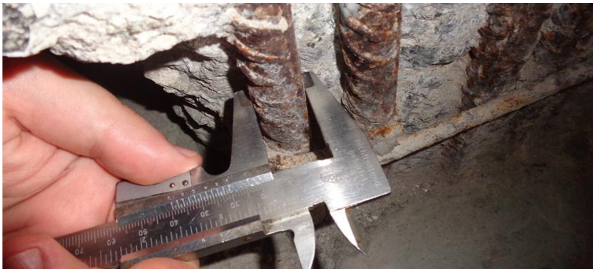
FIGURA 3 – Corrosão do aço em uma estrutura de concreto armado.
