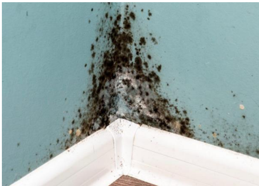
FIGURA 4 – Infiltração em parede residencial
